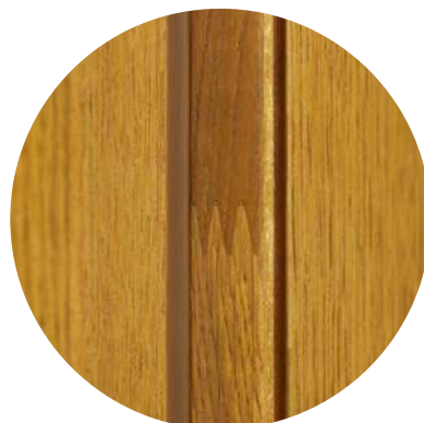
Różnice kolorystyczne łączeń**
